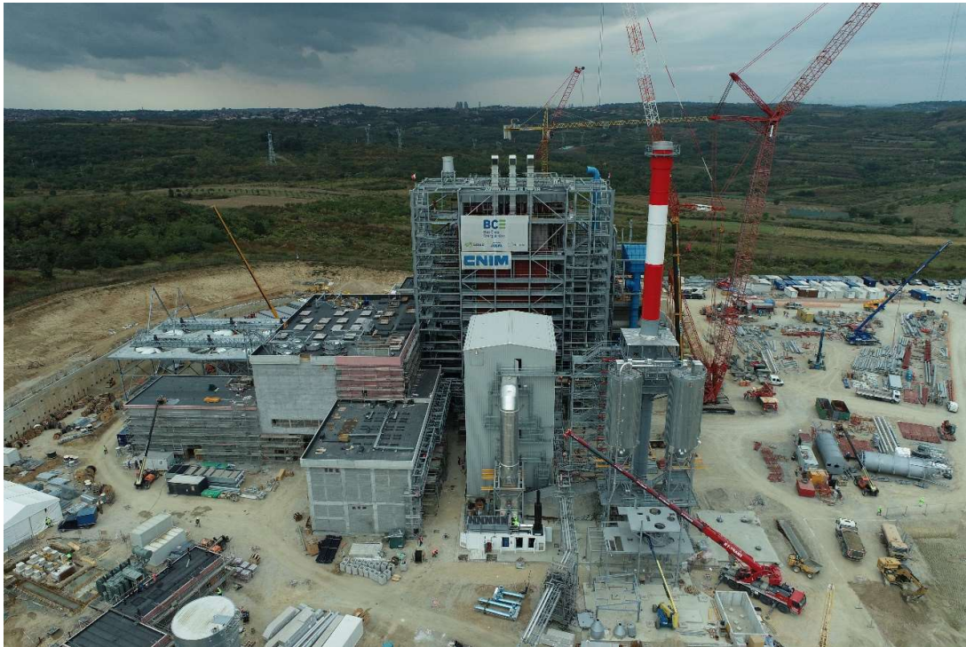
Trabajos en curso en el vertedero de Vinča, junio de 2021. Crédito de la foto: Beo Čista Energija
